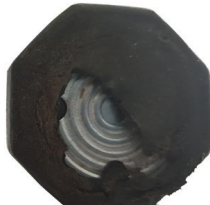
Nožička je poškozena
